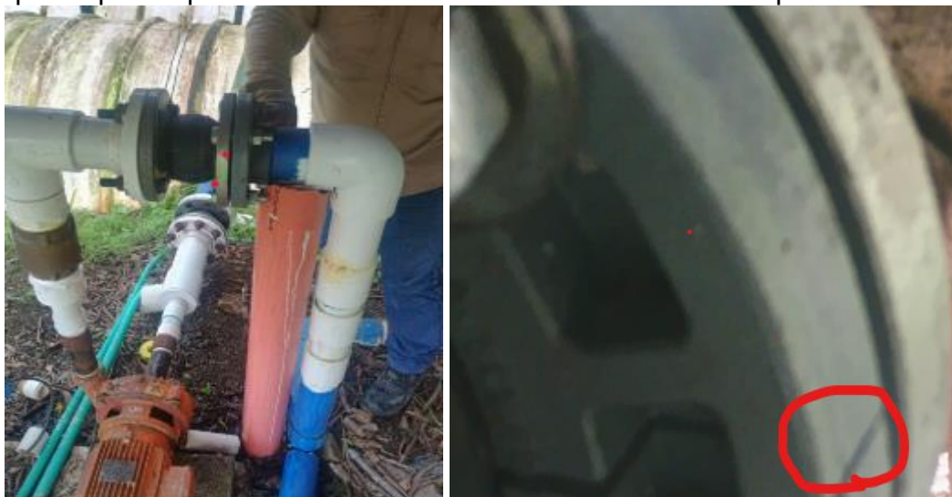
Figuras 1 y 2: Brida de conexión reventada y con fuga.
